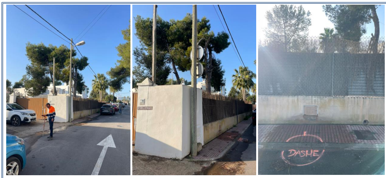
Ilustración 5 - – Identificación y evaluación de la fuga en [Ubicación específica de la incidencia].
